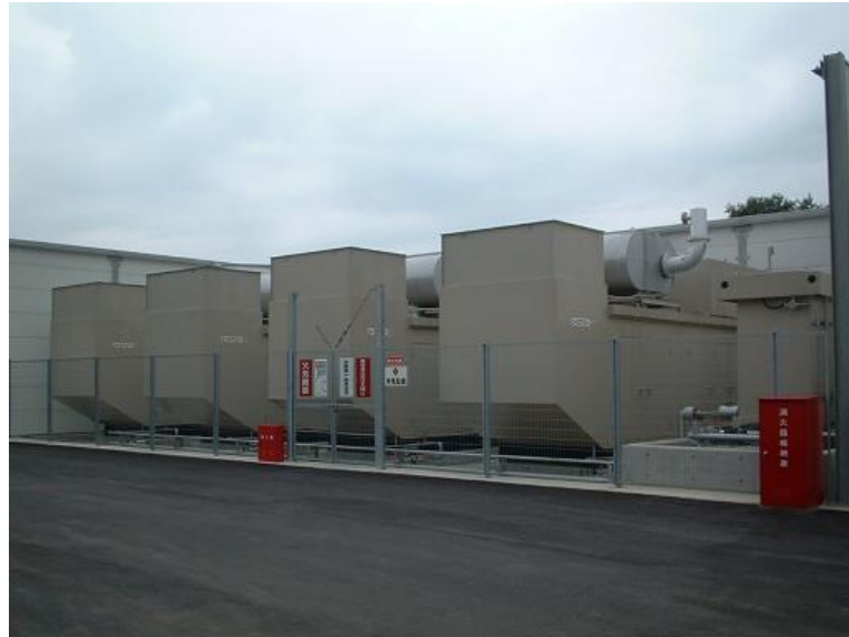
【員弁工場の自家発電装置】
