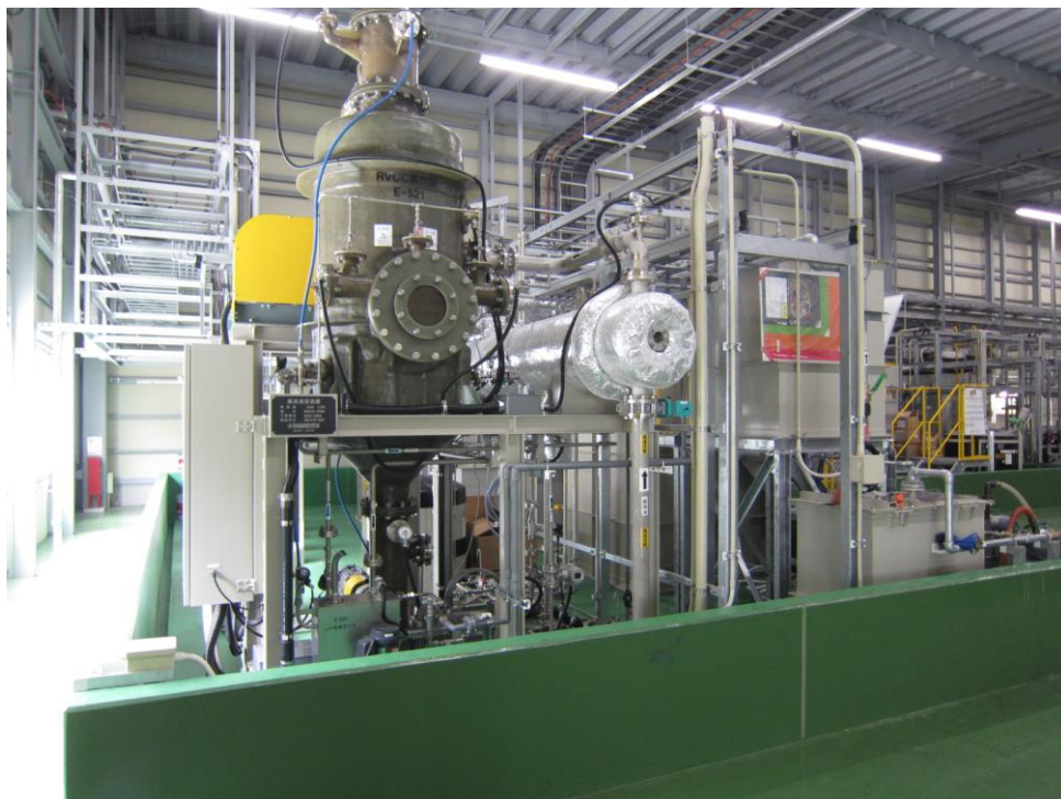
KYB 岐阜東工場の廃液減容装置
