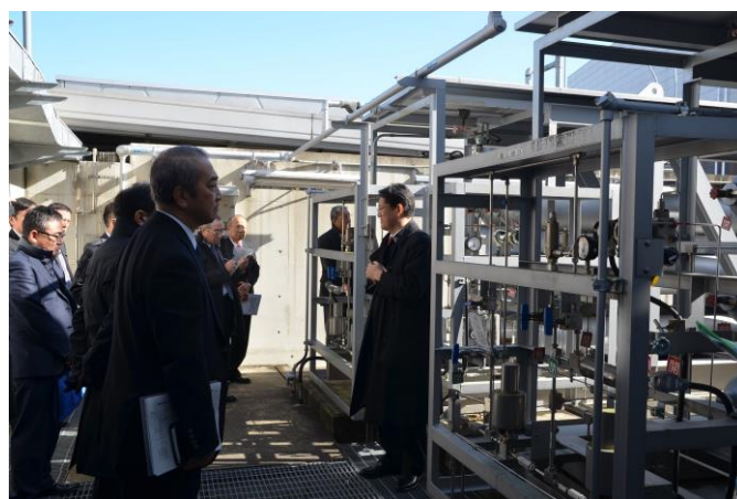
【水素蓄圧器：九州大】
